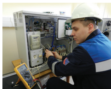
Техник Константин Кокорин осуществляет диагностику, наладку и ремонт станций катодной защиты в лабораторных условиях
