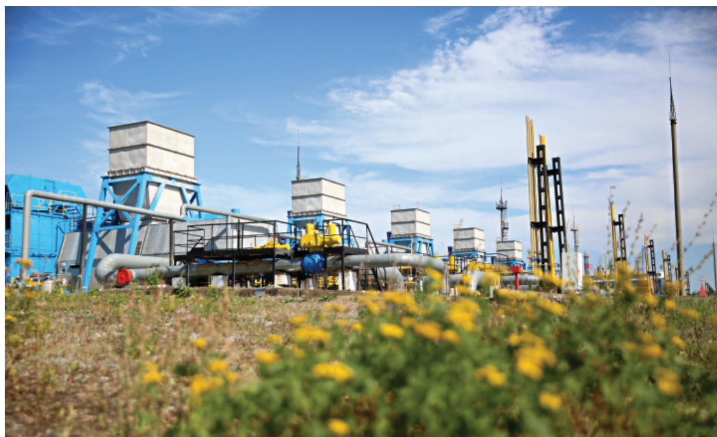
В Чайковском ЛПУМГ на КЦ № 2 продолжаются промышленные испытания двигателя ПС-90ГП-2М с малоэмиссионной камерой сгорания
