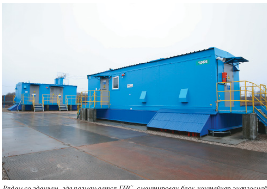
Рядом со зданием, где размещается ГИС, смонтирован блок-контейнер энергоснабжения и блок-контейнер автоматики
