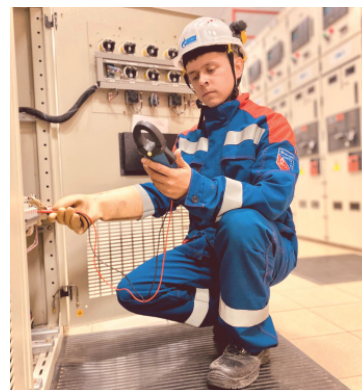
Замер напряжения на щите собственных нужд в 3РУ-10кВ
