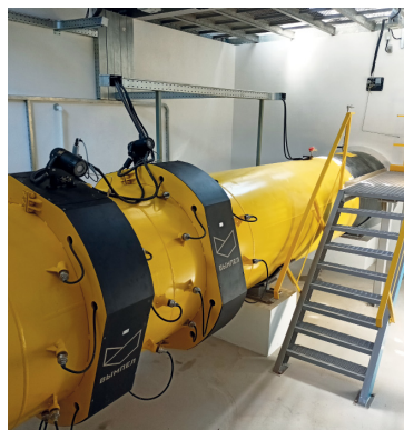
Автоматизированная газоизмерительная станция нового поколения на ультразвуковых преобразователях расхода газа в Увсинском ЛПУМГ
